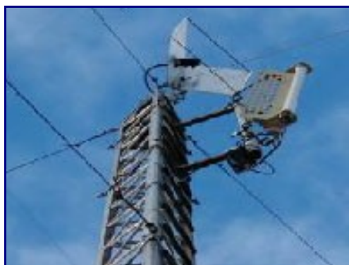
Figura 2: Antena de Solectek instalada en Mérida, Venezuela en 1997 como parte de RETIEM, Red Teleinformática del Estado Mérida, con enlaces de hasta 40 km.
